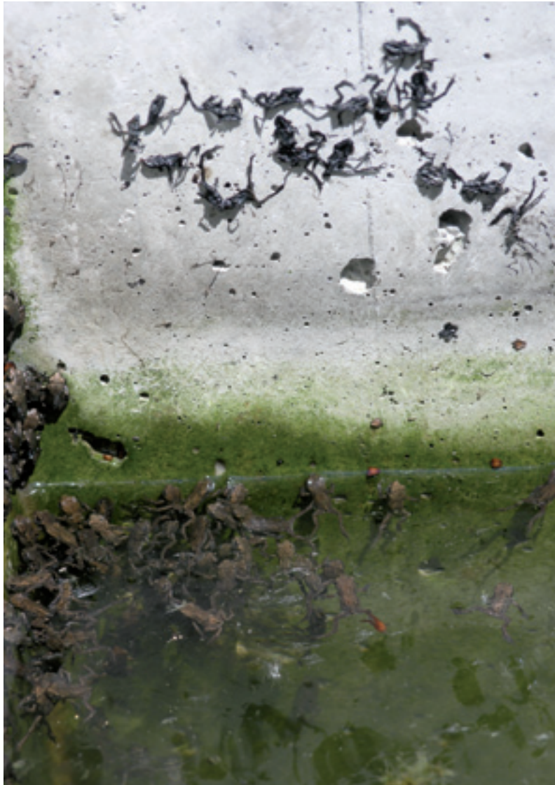
Abb. 96: Erdkröten haben in einem betonierten Becken gelaicht. Die jungen Erdkröten vertrocknen beim Versuch, das Becken zu verlassen. (Foto: Markus Grabher)
