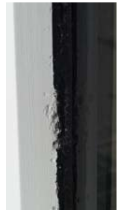
Rabenkrähen sind Verursacher dieser Schäden an einer Terrassentüre. Auch der Lärm, den die Vögel dabei verursachen ist für die Bewohner störend.
